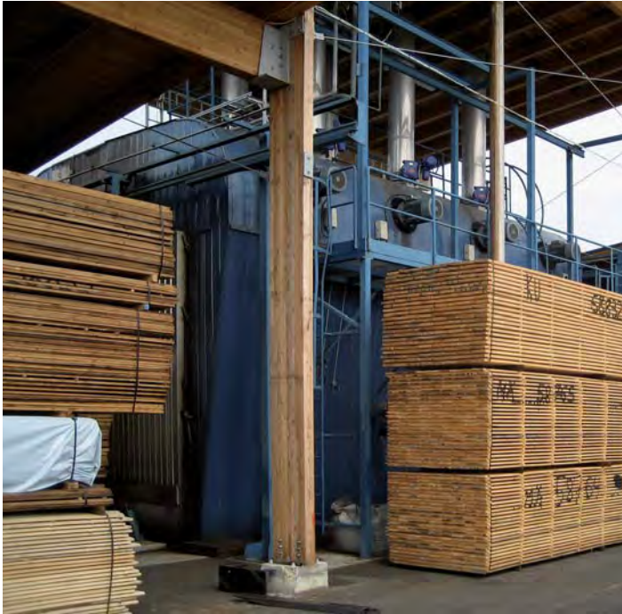
Anlage zur thermischen Modifizierung von Holz mit dem Fassungsvermögen von max. 60 m³ www.tmtgeneration.com
